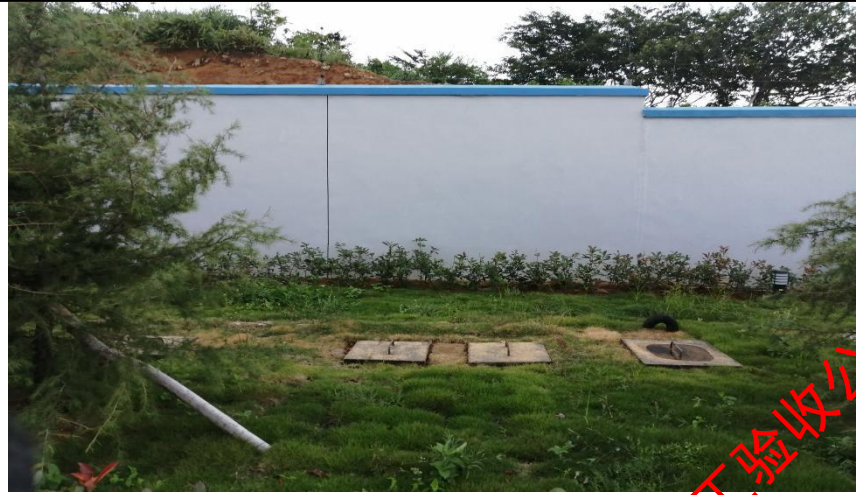
图片9一体化污水设施
