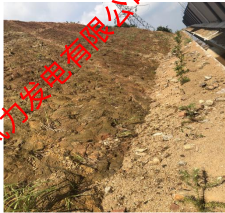
图片 5 升压站绿化
