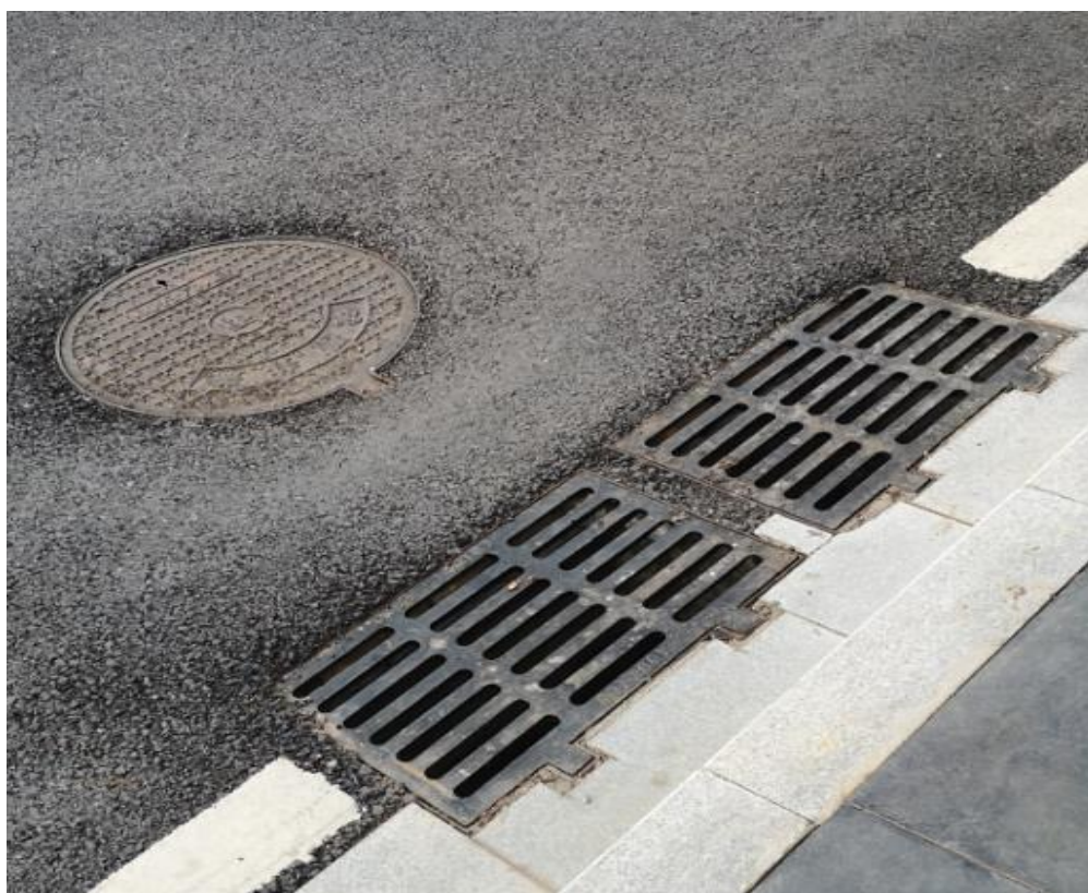
项目区排水设施
