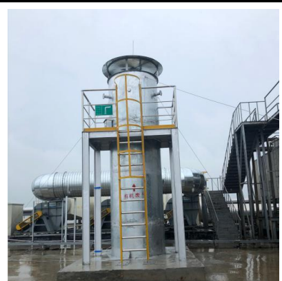
注塑废气排气筒
