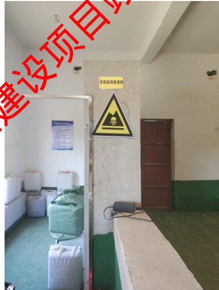
在线监测废液暂存间
