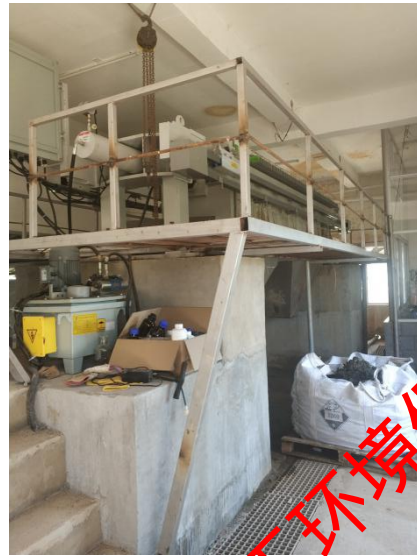
污泥板框压滤机
