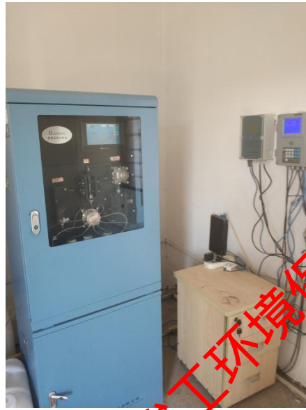
氨氮在线监测设备（进水口）
