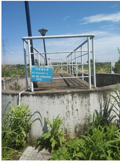
污泥浓缩池（储存池）
