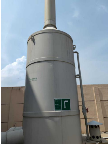
3#排气筒废气排放口标识
