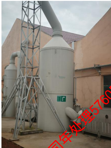
5#排气筒废气排放口标识
