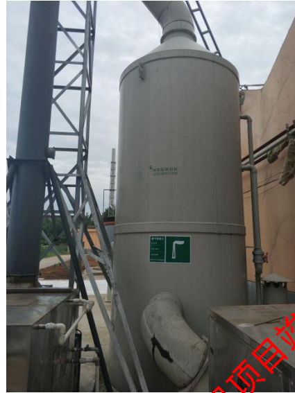
4#排气筒废气排放口标识
